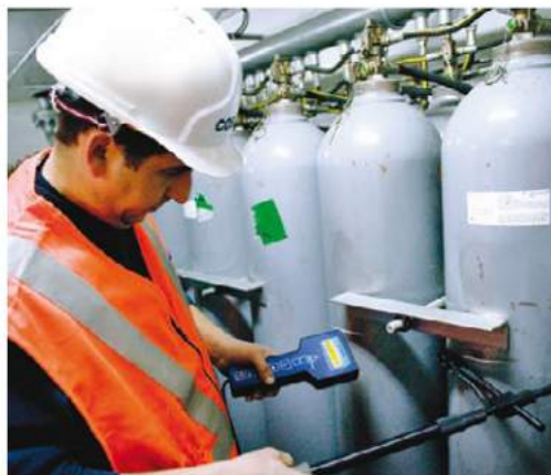
Prüfung und Wartung von komplexen Löschanlagen. Inspection and maintenance of complex CO 2 -firefighting installations.
